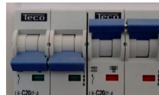
FOTO 5: Zekeringen staan AF AAN
